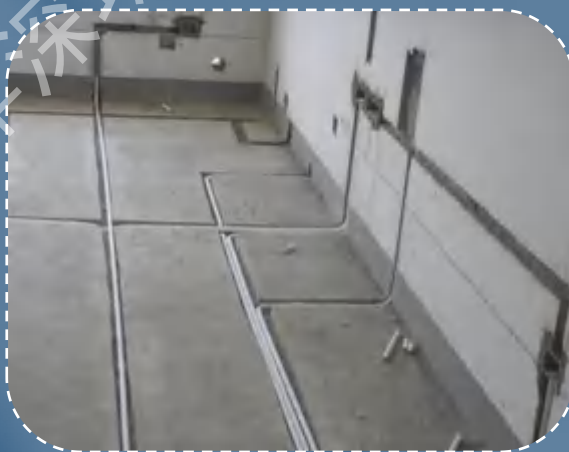
地面开槽，破坏结构
