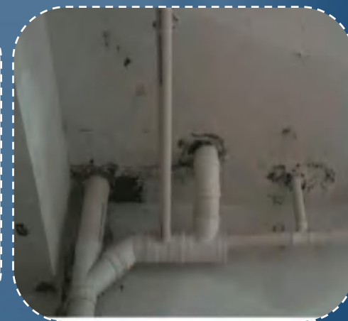
卫生间易漏水
